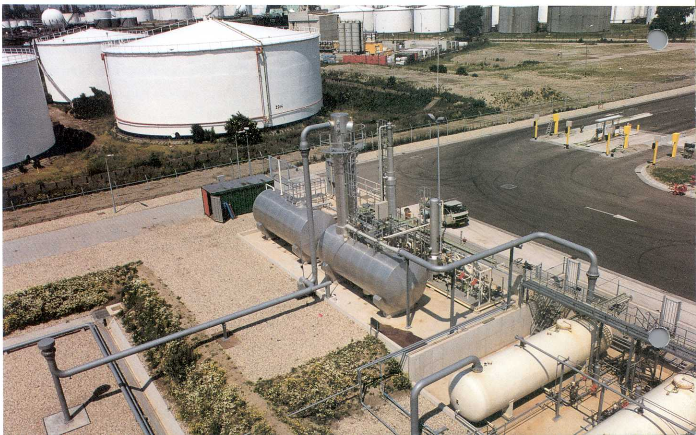
Dampturbineninstallatie bij Shell Pernis/foto Wiese Loading Technology, Stolwijk
