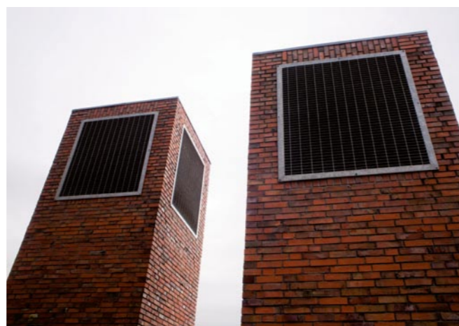
Voorbeeld uitblaasopening ventilatiesysteem parkeergarage (Amsterdam)
