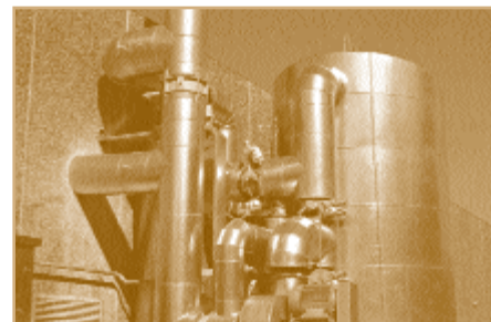
Naverbrander zuivert restgassen van VOS en geur (Foto: ACS Filtertechniek, Alkmaar)
