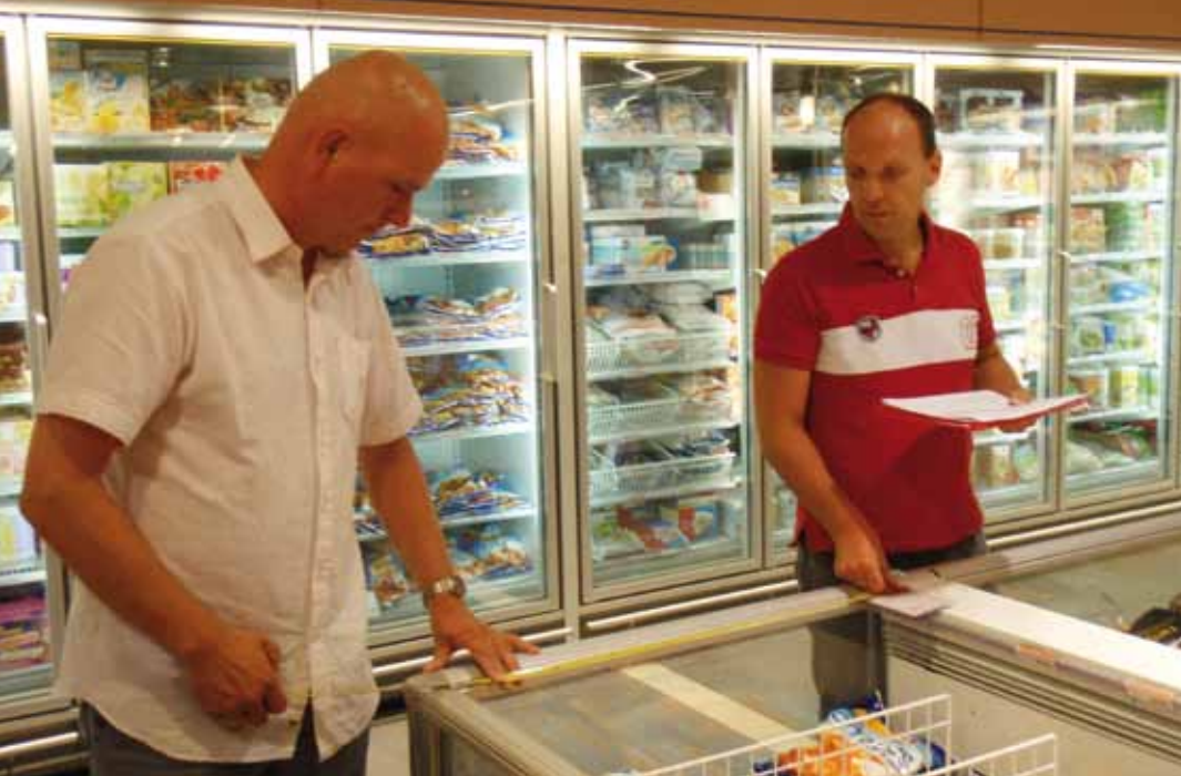
De verticale vriesmeubelen zijn in deze supermarkt reeds afgedekt. De horizontale meubelen nog niet.
