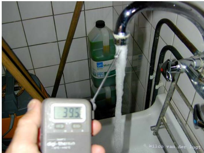
Figuur 5 De watertemperatuur aan het tappunt dient minimaal 60 °C te zijn Bron: Wilco van der Lugt Installatietechniek v.o.f., Alkmaar
