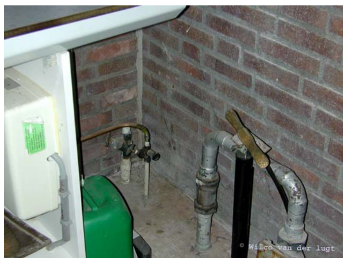
Figuur 4 In dode leidingen met weinig doorstroming kan Legionella zich vermenigvuldigen Bron: Wilco van der Lugt Installatietechniek v.o.f., Alkmaar
