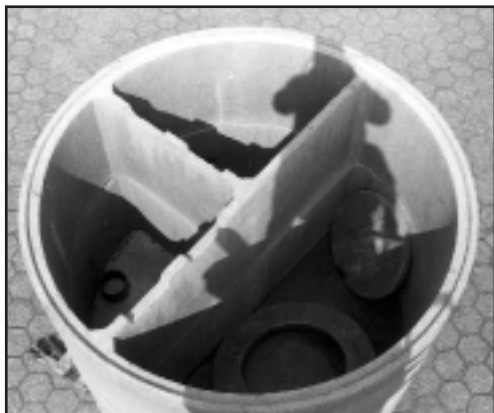
Binnenwerk van een septictank
