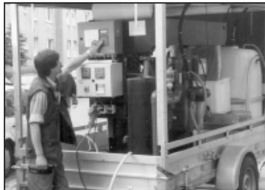
Mobile zuiveringsinstallatie (foto: Enviro - Chemie)
