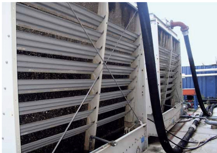
Figuur 6. Louvres van een koeltoren. Op de foto is verder door de louvres het water te zien wat via de pakketten naar beneden valt en opgevangen wordt in het bassin.
