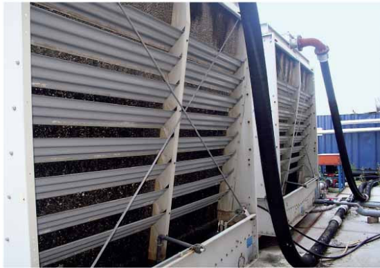
FIGUUR 2. Inlaatkanten van koeltorens waardoor buitenlucht wordt aangezogen. In een koeltoren wordt warm koelwater gekoeld door het te sproeien door de buitenlucht binnenin de toren. De warmte wordt door een uitlaatopening bovenaan de toren afgevoerd met de luchtstroom. Daarbij vernevelt een deel van het water, waardoor een koeltoren vochtige damp afgeeft. Het grootste deel van het water valt gekoeld in een bak onderin de toren, waaruit het wegstroomt om opnieuw als koelwater te worden gebruikt.
